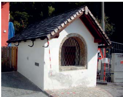
An der kleinen Kapelle in der Höttinger Dorfasse hat der Zahn der Zeit genagt!
